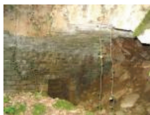
Demeure. Sous-sol voûté en plein-cintre d'un bâtiment effondré.
